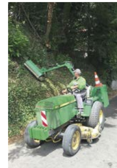
Pulizia dei Cigli Stradali che coinvolgeranno progressivamente tutto il territorio comunale; un ringraziamento particolare all'Ufficio Tecnico Comunale che si è occupato della programmazione degli interventi insieme
