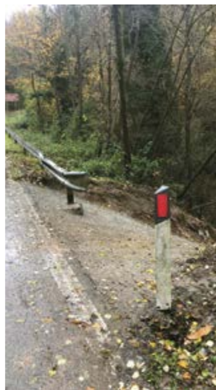
Realizzato in via BRIGATA PARTIGIANI ALBENZA il canale di SCOLO delle ACQUE METEORICHE , ringrazio per la collaborazione l'impresa esecutrice e tutto lo staff dell' UFFICIO TECNICO COMUNALE .
